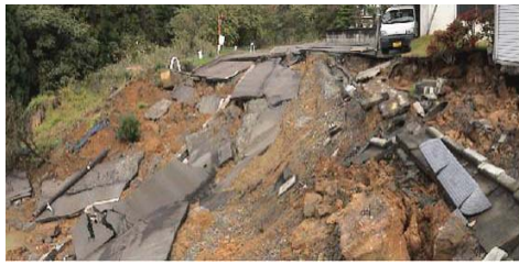
新潟県長岡市高町の盛土造成地の滑動崩落現象 国土交通省 都市・地域整備局（平成19年） 「大規模盛土造成地の変動予測調査ガイドラインの解説(案)」
