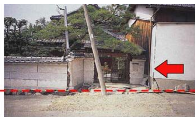
阪神・淡路大震災で発生した滑動崩落現象に伴う被害 (提供：京都大学 釜井俊孝教授)
